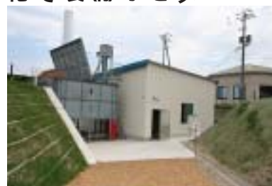
木質バイオマスチップボイラー施設
