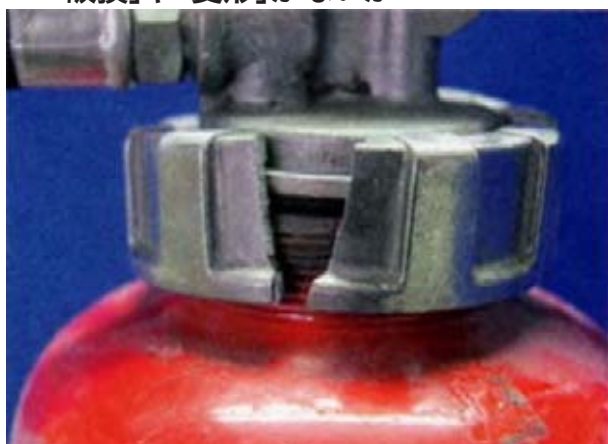
使用に耐えない破損
