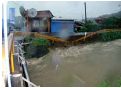
7月の大雨により被災した町道畠田柳尾線の護岸
