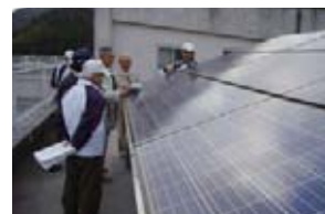
福賀小学校に設置された太陽光発電設備
