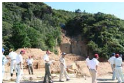
国道191号のり面崩壊現場
