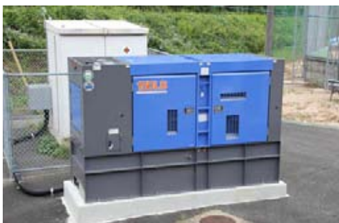
夜間照明用発電機
