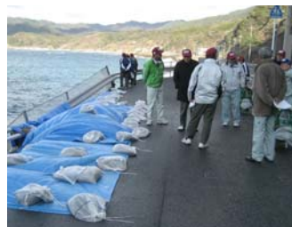
町道宇田中央線路肩崩落現場
