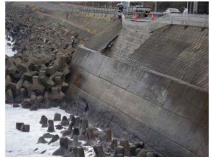
町道宇田中央線の浸食箇所
