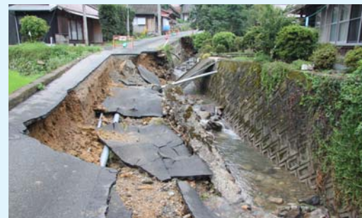
町道王子ヶ坂惣郷線の路面崩落現場(惣郷)
