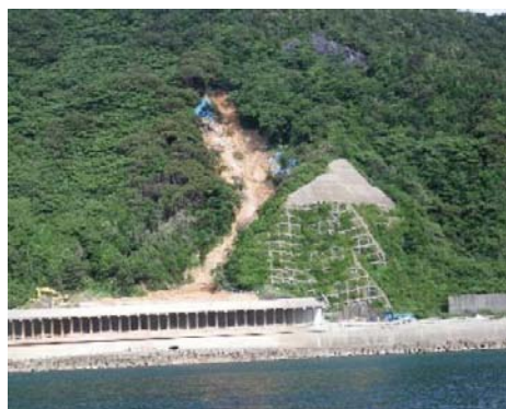
H23年土砂崩壊の状況
