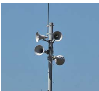
防災無線屋外スピーカー
