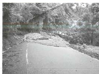
7月1日の集中豪雨による県道益田阿武線の土砂崩れ
